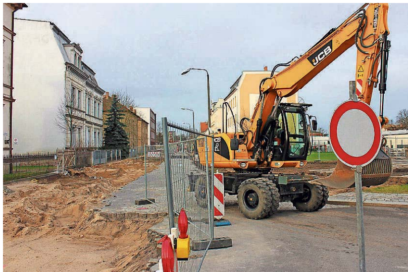
Die Bauarbeiter der Firma ULT haben derzeit alle Hände voll an der Alten Poststraße in Guben zu tun. Bis Ende Juni soll der Abschnitt zwischen Bahnhofstraße und Kreuzung Uferstraße ausgebaut werden. „Die reinen Baukosten betragen insgesamt 500 000 Euro“, erklärt Stadtspreecherin Susann Winter auf Nachfrage. Über das Interreg IV A-Programm wird der Ausbau zu 85 Prozent gefördert. Es ist das letzte Sanierungsvorhaben im Projekt „Landschaftsgestaltung des Neiße-Ufers in der Eurostadt Guben-Gubin“. Foto: Bernhard Schulz
